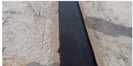
マトリクス502合材を舗設・転圧後、その上をバインダーでさらに被覆
