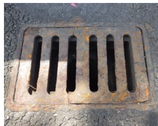
錆により腐食した柵蓋(橋梁用)
