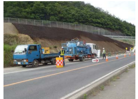
【参考】種吹付設備
