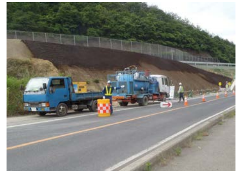
【参考】種吹付設備
