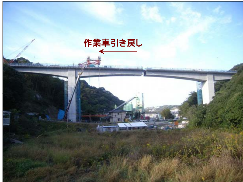
作業車を橋脚付近まで引き戻した後、作業台を桁下に吊り降ろし、クレーンを使用して解体する
