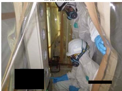
環境対策設備
