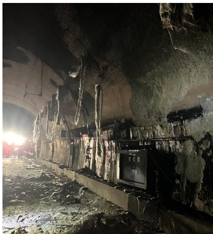
[トンネル内部の焼損状況]
