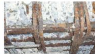
鉄筋腐食状況の事例
