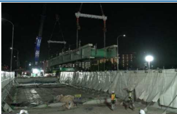
中国自動車道 東ノ迫池橋 (大規模更新／高速道路の長期保全)
