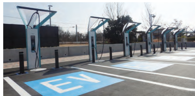
急速充電設備
