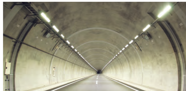
トンネルLED灯
