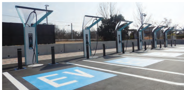
急速充電設備
