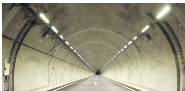
トンネルLED灯
