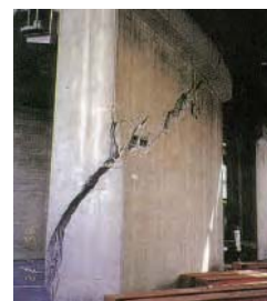
阪神淡路大震災時における高速道路損傷状況
