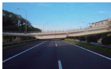
府領第一橋(落橋した直後の様子)
