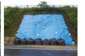
のり面崩壊状況（応急復旧後）
