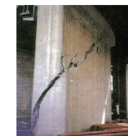
阪神淡路大震災時における高速道路損傷状況
