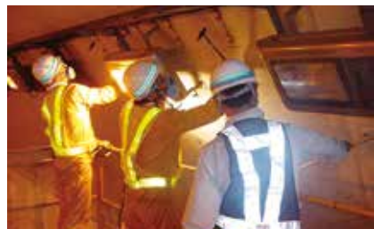
道路や設備等の維持管理
