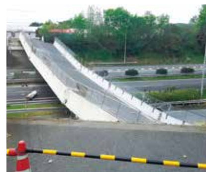
府領第一橋（落橋した直後の様子）
