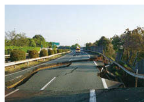
被災直後の崩落箇所
