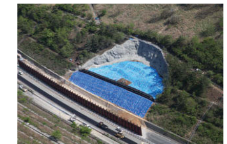
大分道 切土のり面崩落箇所
