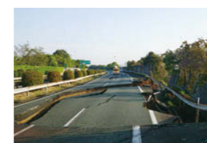
被災直後の崩落箇所
