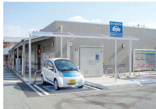
自動車走行時のCO 2 排出量を削減するために、自治体との連携のもと、EV用急速充電器の設置を進めています（名神高速道路・吹田SA上り線）
