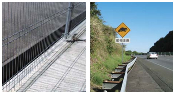
タヌキ等の侵入を防ぐフェンス下部の隙間対策例
