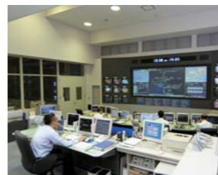
道路管制センター（施設制御）
