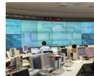
道路管制センター（交通管理）
