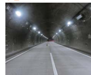
LED照明の導入 (高松自動車道)
