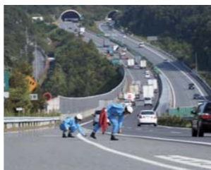
路上障害物の排除
