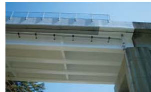
国道と交わる重要交差点箇所に繊維シートを貼付しています
