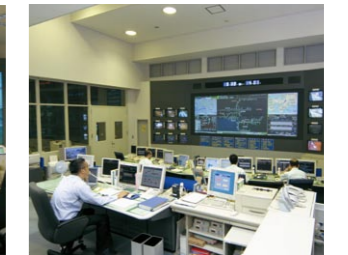
道路管制センター（施設制御部門）
