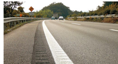
高輝度レーンマーク
