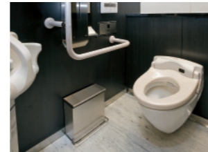
洗浄器付洋式トイレ
