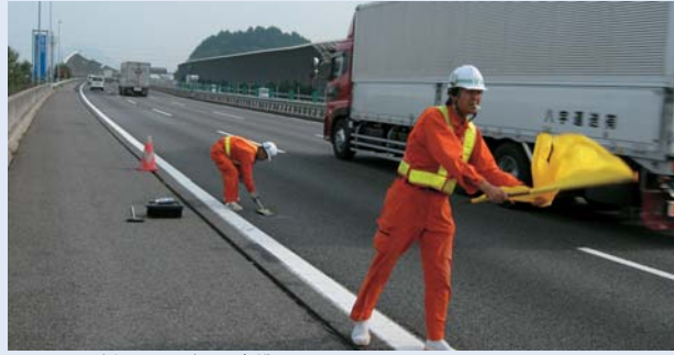
ポットホール（路面の凹凸）の緊急措置
