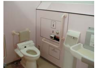
洗浄器付洋式トイレ
