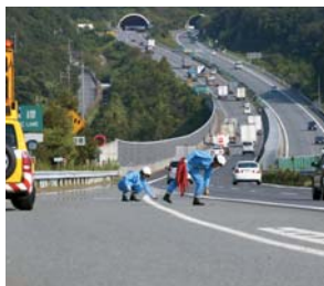
路上障害物の排除
