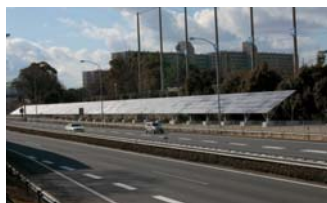
名神吹田インターチェンジの太陽光発電設備
