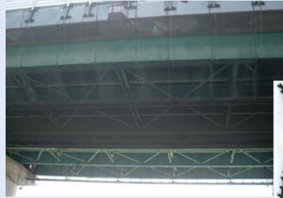
はく落防止ネット
