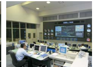
道路管制センター（施設制御部門）
