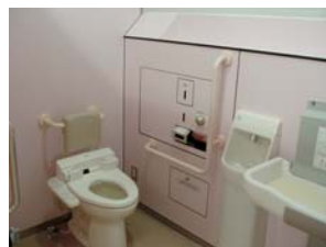
洗浄器付洋式トイレ
