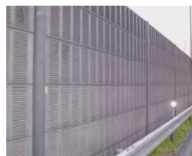
統一型遮音壁
