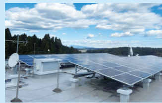
社屋上への太陽光パネル設置(九州支社 宮崎高速道路事務所)
