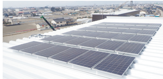
料金所の屋根に設置した太陽光パネル
