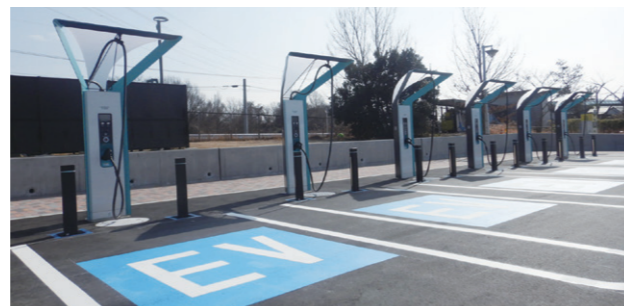
急速充電設備
