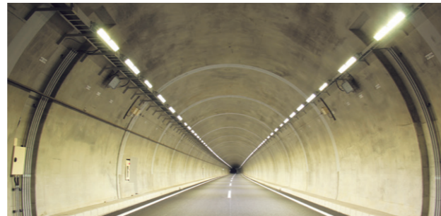
トンネルLED灯
