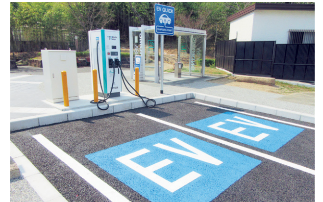
急速充電設備
