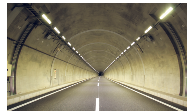
トンネルLED灯
