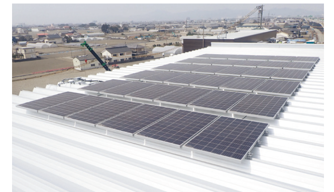
料金所の屋根に設置した太陽光パネル
