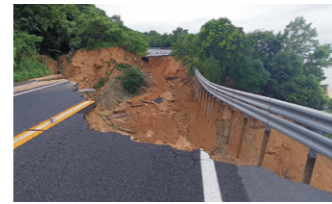
2018年西日本豪雨による広島県道路
