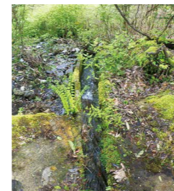
修繕前の縦溝
