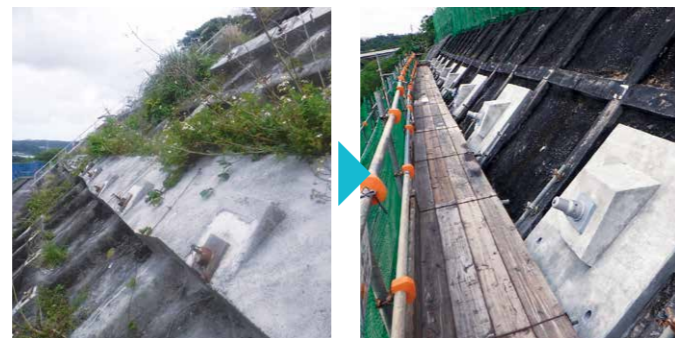
損傷しているアンカー
