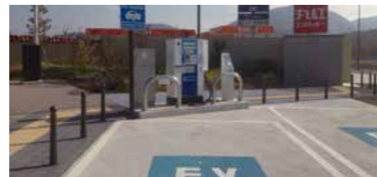
新名神高速道路宝塚北SAの急速充電システム
