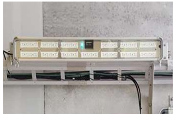
LED照明灯具
