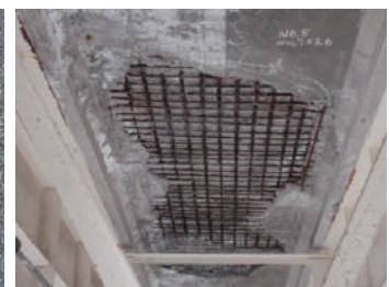
下面 コンクリートの剥離
