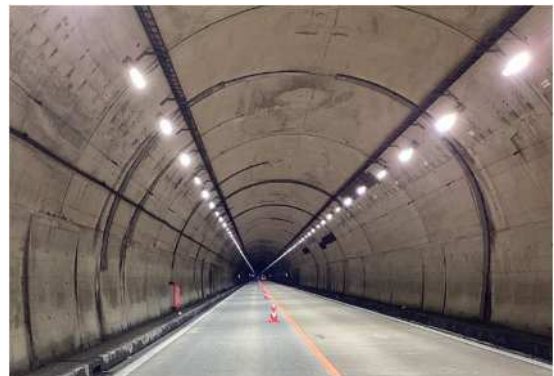
《更新後のLED照明》
