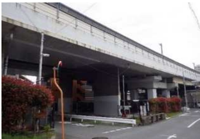
《橋梁上部工はく落対策（補修前）》
