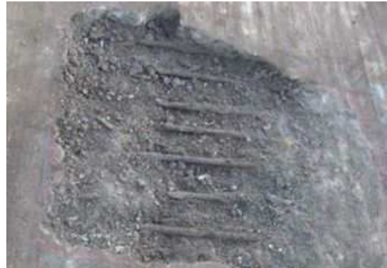
《床版上面のコンクリート土砂化》
