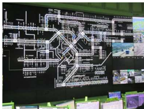
《道路管制センター》
