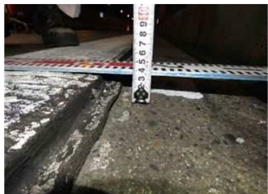
《トンネル路面隆起による段差》
