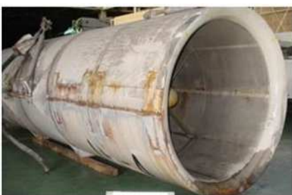
《トンネルジェットファン（補修前）》
