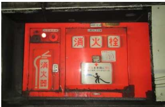
《従前の消火栓》
