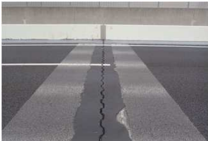
《伸縮装置の損傷（補修前）》
