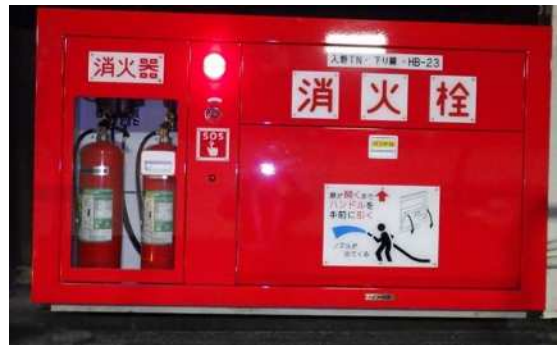
《更新後の消火栓》
