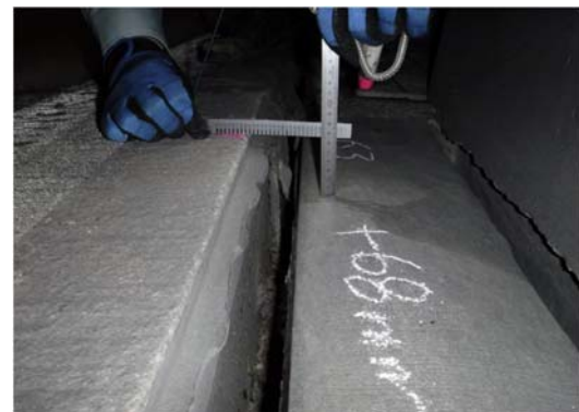
《トンネル路面隆起による段差》
