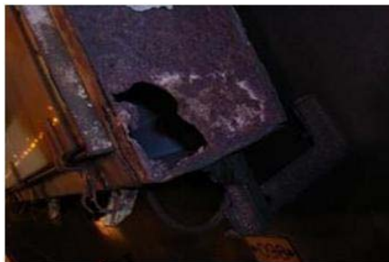
《トンネル照明の緊急補修(補修前)》
