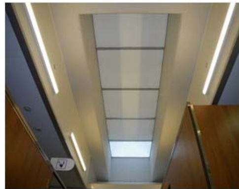
《トイレ照明のLED化》
