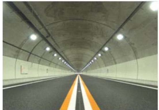
《更新後のLED照明》
