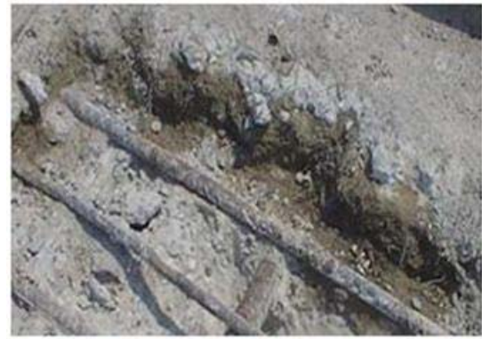
《床版上面のコンクリート土砂化》
