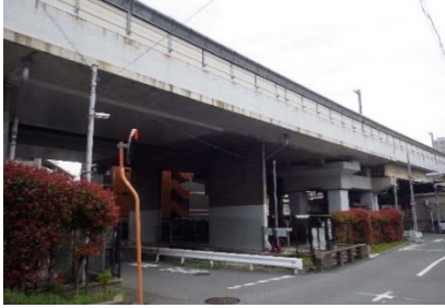
《橋梁上部工はく落対策(補修前)》
