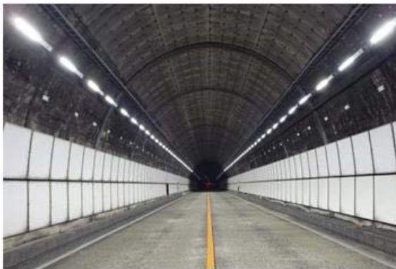
《トンネル照明のLED化》
