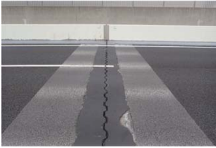
《伸縮装置の損傷(補修前)》
