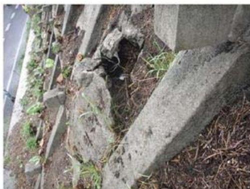
《グラウンドアンカーの機能低下によるり面変状》
