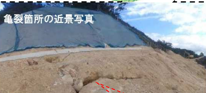
開口亀裂の状況
