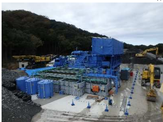
不溶化処理施設全景
