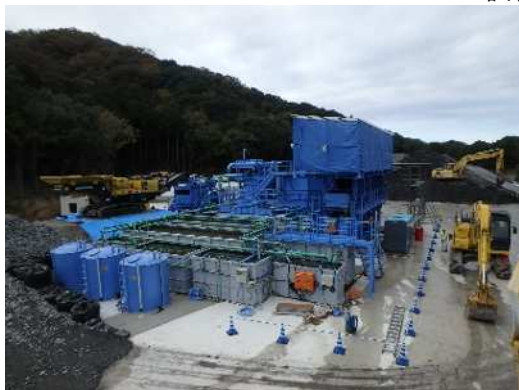
不溶化処理施設全景
