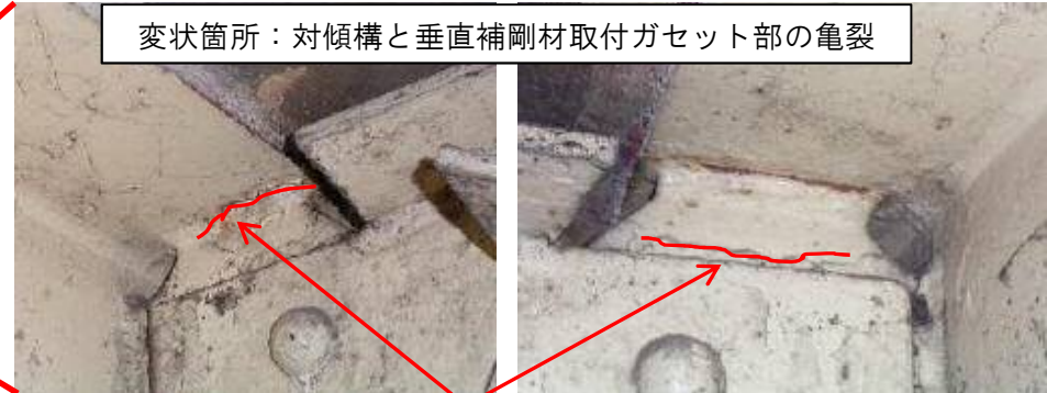
溶接部の亀裂
