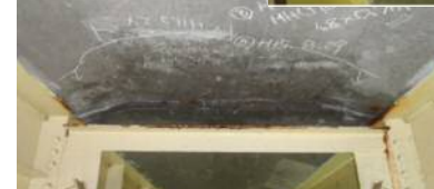
床版下面の漏水による塩害損傷状況
