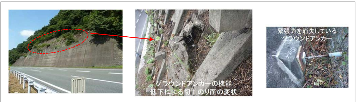
図-3 土構造物(グラウンドアンカー)の主な変状
