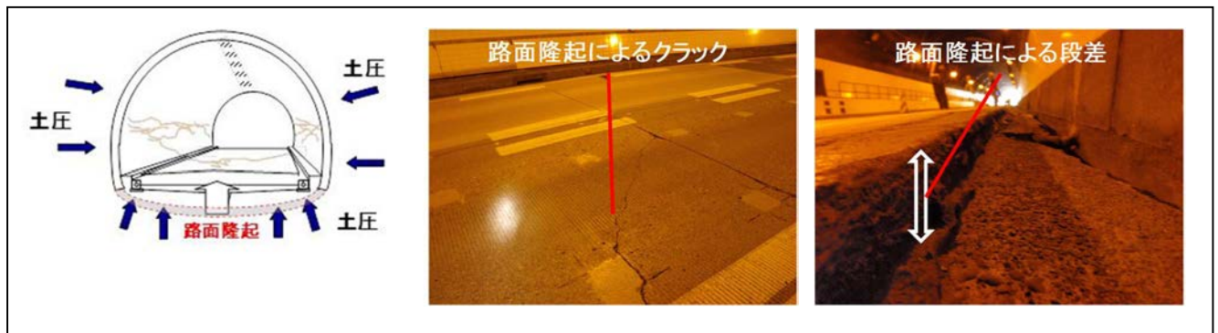
図-4 地盤材料の劣化によるトンネル内空の変状
