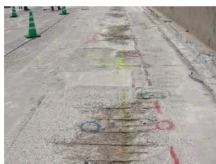
劣化が進行した床版 上面の状況
