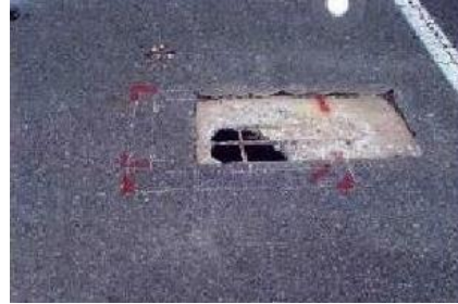
中空床版等の路面陥没等
