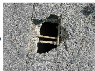
路面の陥没事象
