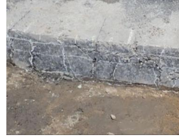
舗装路盤部の疲労破壊
