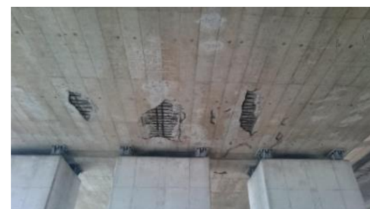
床版下面の剥離
