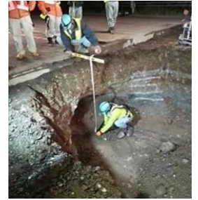
火山堆積物地質における路面陥没
