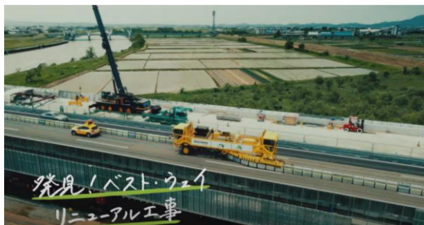
傷んだ床版の取替え前
