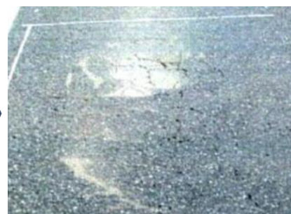
舗装路面のひび割れの発生状況
