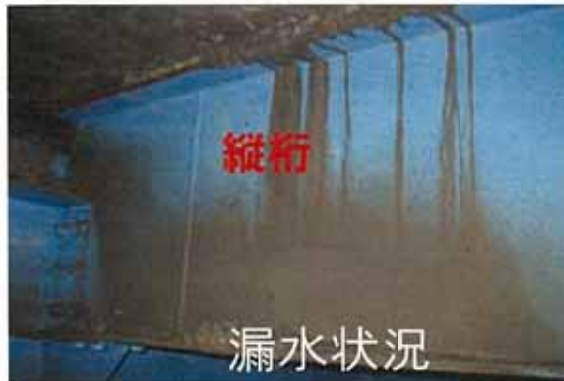
37年後 : 床版貫通ひびわれ噴出状況
