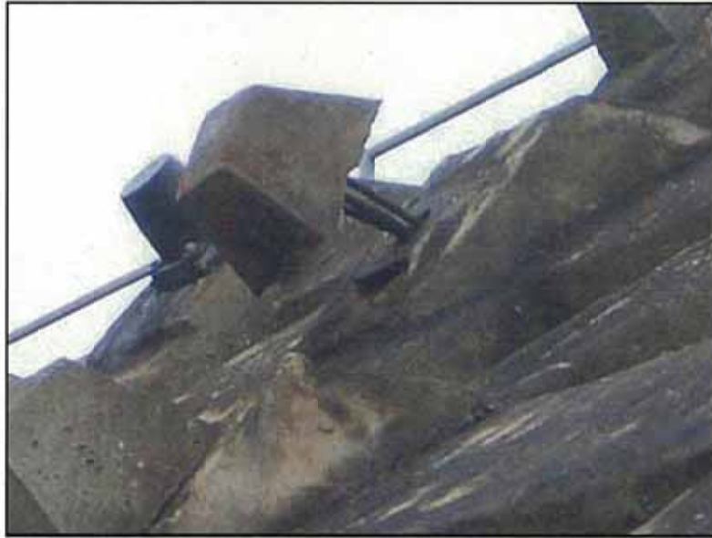
アンカー頭部の腐食・破損
