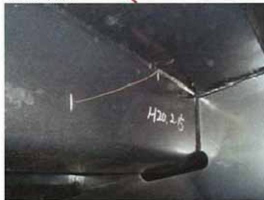
16年後 : 詳細調査(Uリブき裂)
