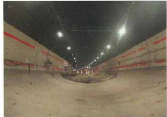
インバート設置による対策状況
