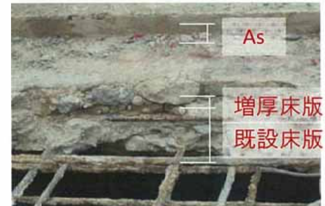
37年後 : 部分打替えによる層状剥離確認
