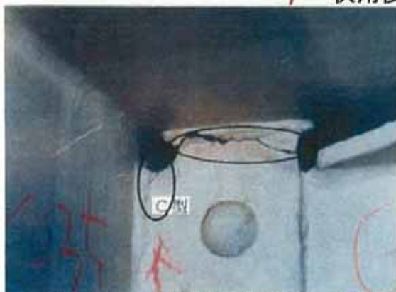
15年後 : 対傾構取付け部のき裂
