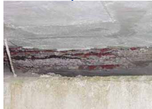
30年後 : 桁の鉄筋腐食
