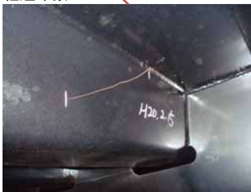
16年後 : 詳細調査(Uリブき裂)
