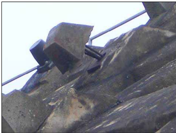
アンカー頭部の腐食・破損
