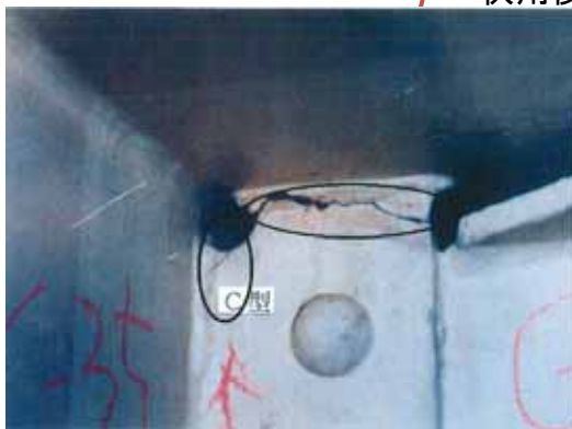
15年後 : 対傾構取付け部のき裂
