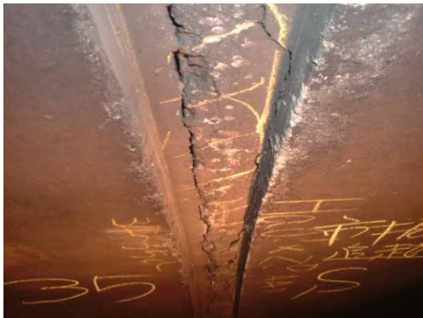
変状状況(目地部はく離)
