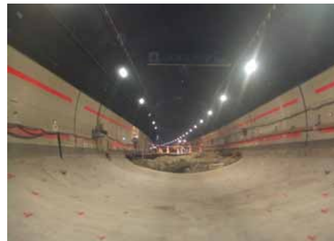
インバート設置による対策状況
