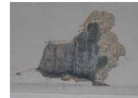
34年後 : 浮き・はく離・鉄筋腐食
