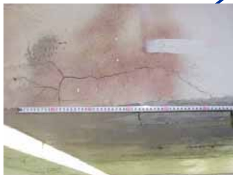
30年後 : 桁のひび割れ
