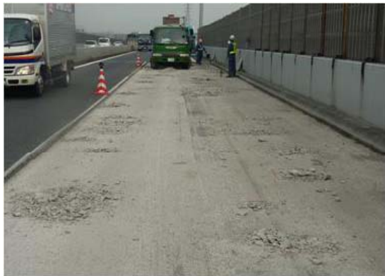
床版の軽微な劣化
