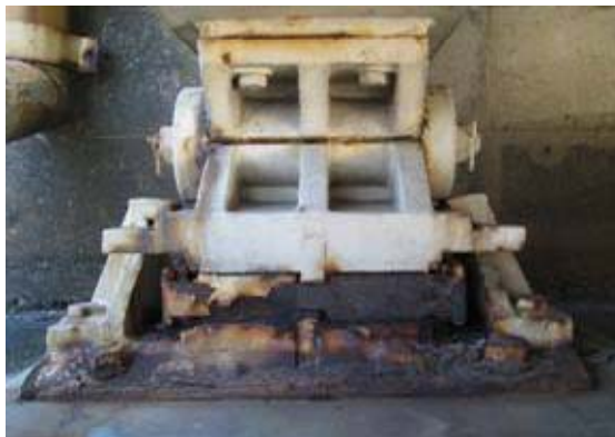
漏水による支承の劣化
