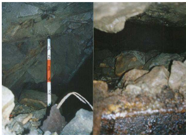
トンネル覆工背面空洞
