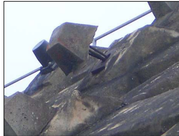
アンカー頭部の腐食・破断
