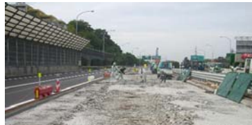
床版の著しい劣化
