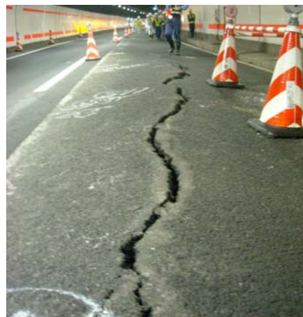
トンネル内空の変状(盤ぶくれ)
