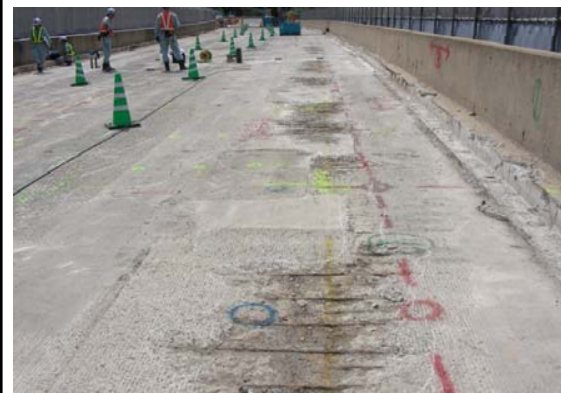
床版上面の劣化
