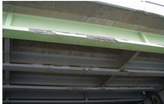
塩分による桁の劣化
