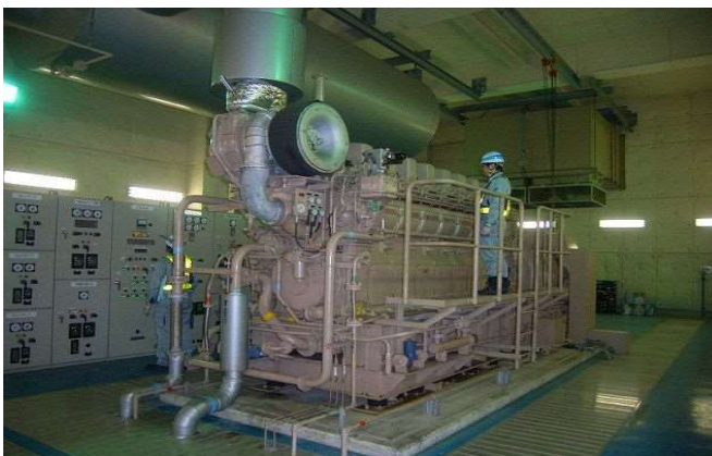
【非常用発電設備】
