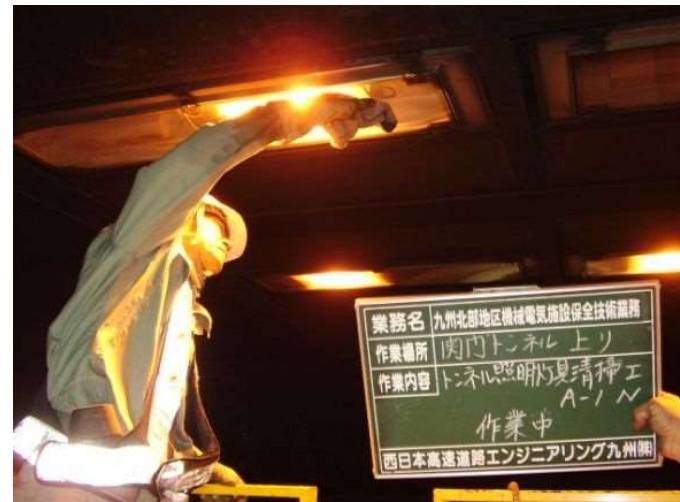
【トンネル照明設備】
