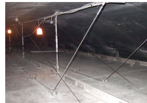
フェールセーフ設置状況
