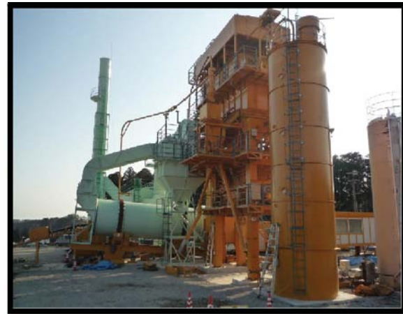
舗装合材製造仮設プラント(川南PA)
