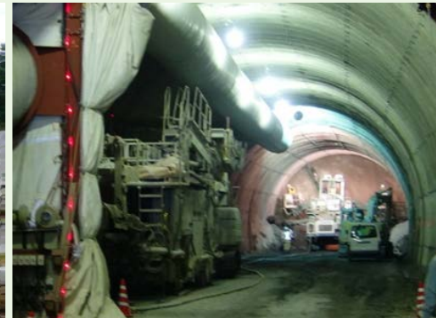
中里トンネル 延長1,507m トンネル掘削中。 掘進延長約230m（7月末現在）
