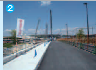
橋梁部は上部工の架設が完了し、橋梁附帯工事を実施中(荒戸橋) 今後は、滋賀県にて橋梁前後の取り付け部の舗装工事を実施予定
