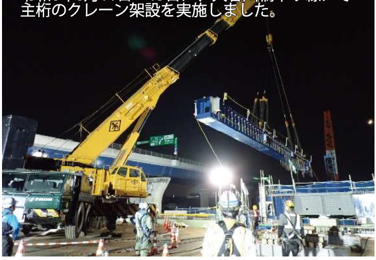
令和6年6月11日～15日に、大谷川橋下り線にて主桁のクレーン架設を実施しました。
