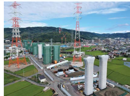
④ 橋脚が8基ほど立ち上がってきました。今後、下部工の施工を進めてまいります。
