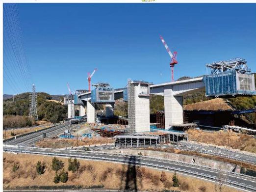
① 橋梁上部工の張出架設及び橋梁下部工の施工を行っています。
