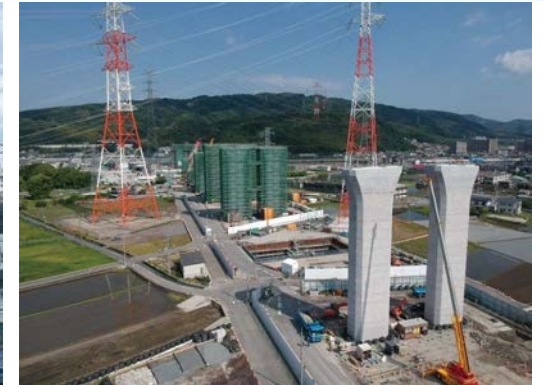
④ 橋梁が6基ほど立ちあがりました。今後も橋梁下部工の施工を進めてまいります。
