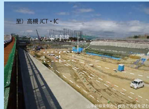
⑦ 山手幹線付近でボックスカルバート施工のため地盤改良を行っています。
