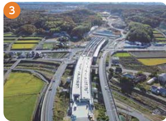
菅野交差点付近 県道明石木見線、櫛谷川を横架する橋梁工事を実施しています。
