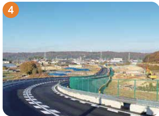
下村地区う回路 西神1号線~国道175号間の市道を迂回路に切替えました。速度を十分に落として通行ください。
