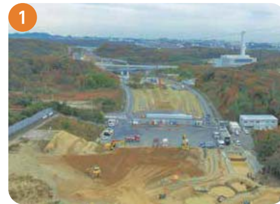
永井谷 JCT 付近 永井谷JCTにおいて、橋台、橋脚の基礎工事、山を掘削する土工工事を実施しています。
