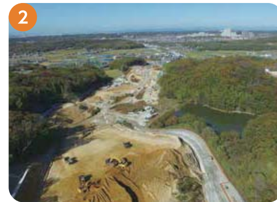
櫛谷 IC 付近 永井谷JCTから県道明石木見線と交差する間において、山を掘削する工事を実施しています。
