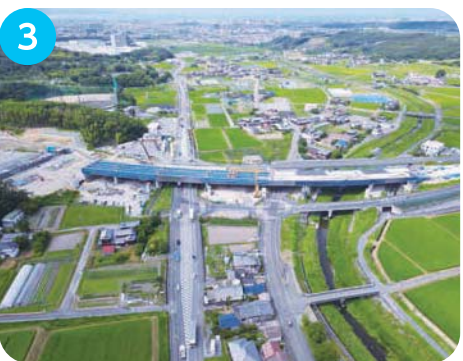
3 菅野交差点付近 専用部の橋梁は床版工事を実施しています。
