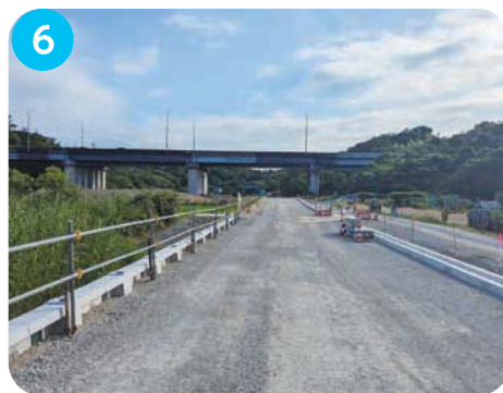
6 石ヶ谷JCT~明石SA 付加車線事業の工事が必要となる工事用道路の工事を実施しています。
